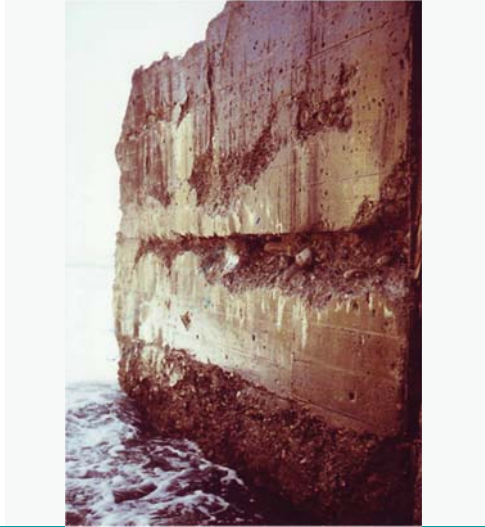
海岸構造物の凍害
