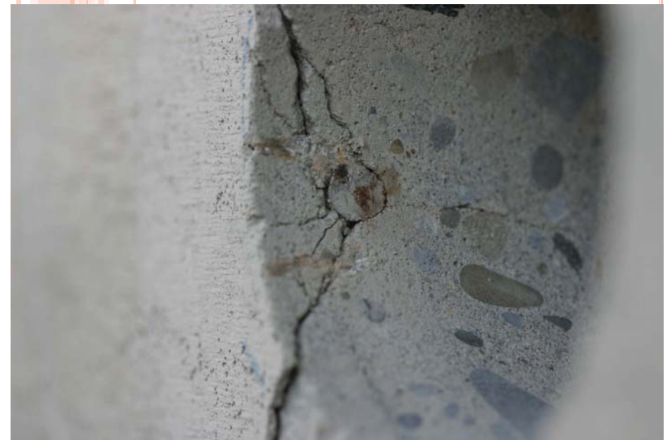
写真 コンクリートの断面(鉄筋からひびが走っているところに注目)
