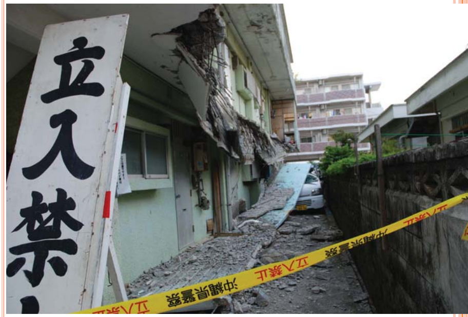
沖縄のアパートの廊下崩壊
