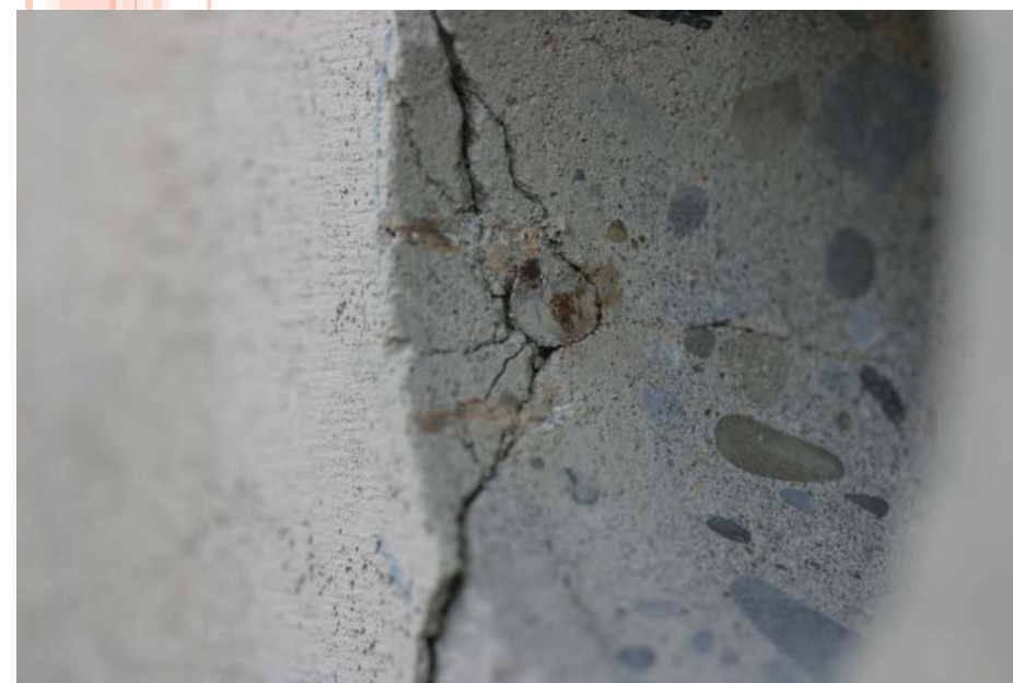
かぶりコンクリートが鉄筋の腐食時の膨張圧で押し出される
