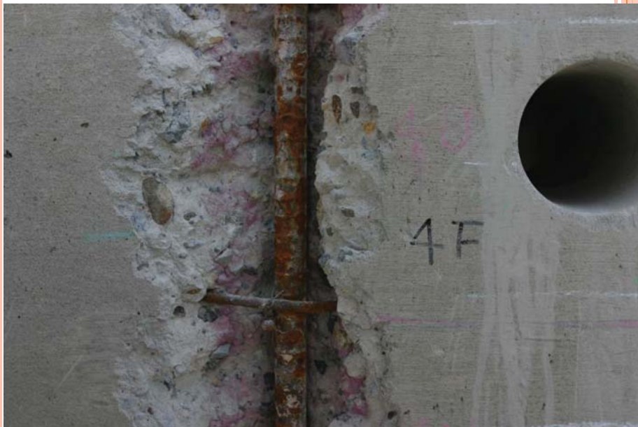
写真 打放しコンクリートのはつり調査(屋外側が屋内側よりも鉄筋の腐食が激しい)
