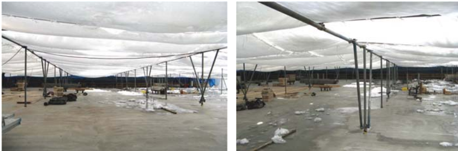
単管支柱にワイヤーを張りシートにて囲い、コンクリート打設時は採暖。
