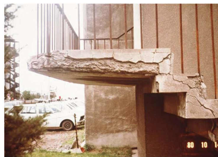
屋外階段の凍害
