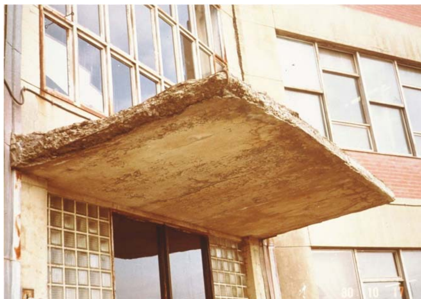
写真-10 庇の凍害(出っ張っている庇は水のたまる場所、温度変化が激しいところ。日射を受ける南、西が劣化大。南よりは西。)
