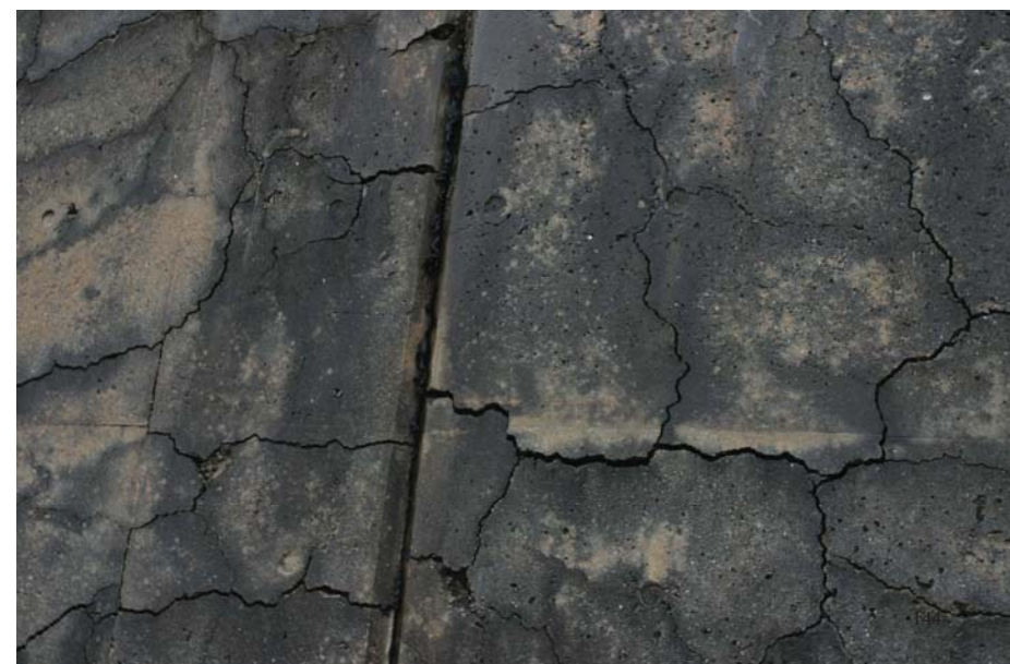
写真-18 アルカリシリカ反応による劣化
