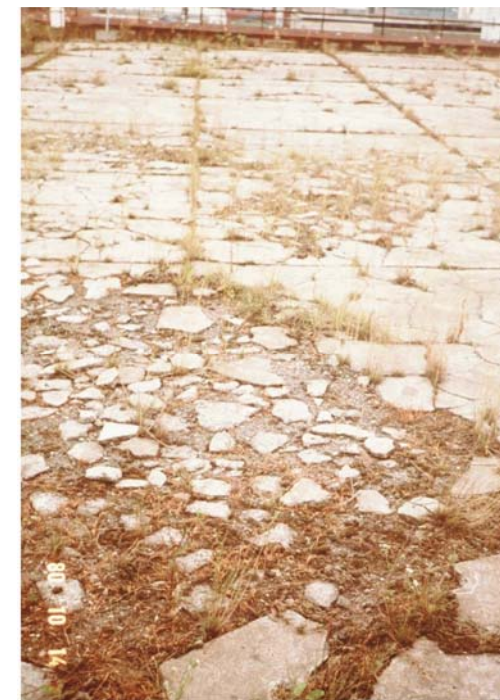
写真-17 防水押えの凍害 (昔は安易に nonAEコンクリ ートを使ったこと が多かったこと もあり凍害を受 けやすい部位で あった)
