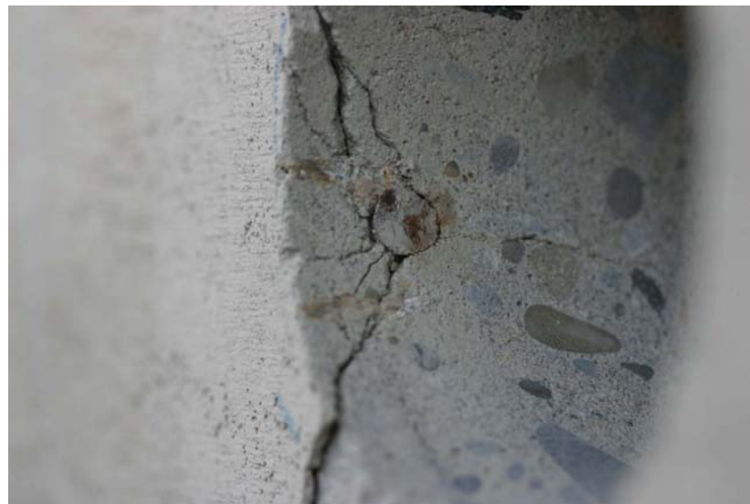
写真-6 中性化による鉄筋腐食とかぶりコンクリートの押し出し(コンクリートの断面)
