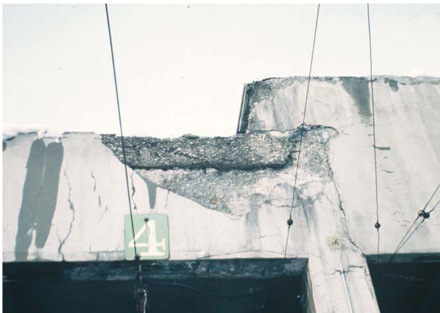
写真-13 段差のあるところの凍害(段になっているところには雪がたまる。それが融けるので水がたまることになる)
