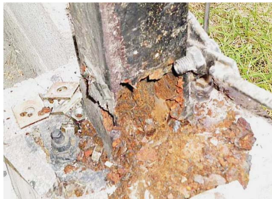
写真-4 鉄骨柱脚部の腐食
