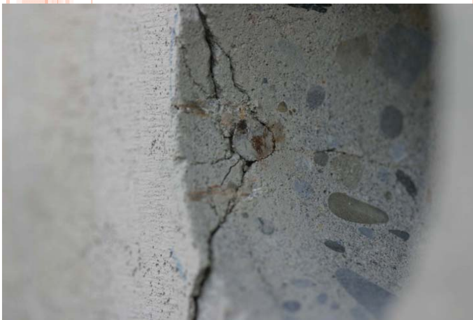
写真 コンクリートの断面(鉄筋からひびが走っているところに注目)
