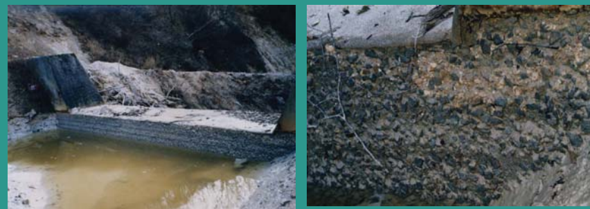
pHが3以下の強い酸性温泉地の下流に位置する砂防ダムの腐食例その2
