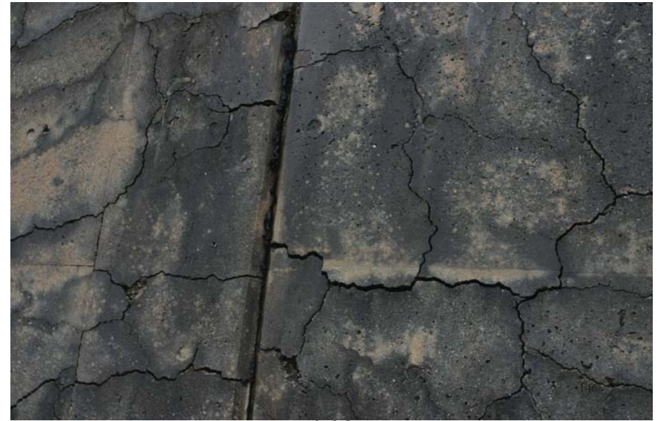
写真-18 アルカリシリカ反応による劣化
