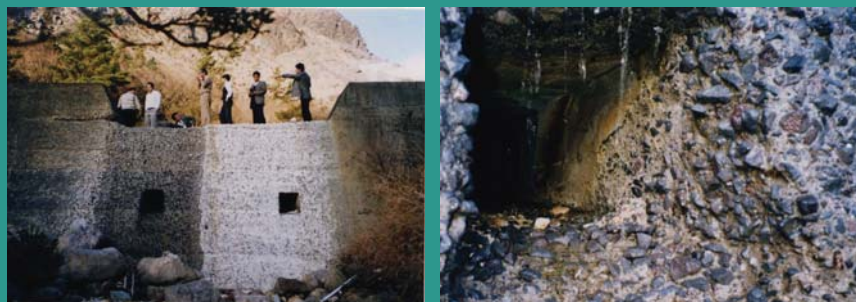
pHが3以下の強い酸性温泉地の下流に位置する砂防ダムの腐食例
