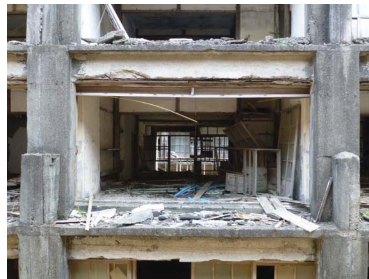
写真-1 軍艦島の惨状(廃屋となった後、窓・外壁の崩壊により内外装材が散乱、内部コンクリート躯体の劣化が進行)
