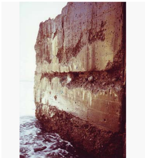
海岸構造物の凍害
