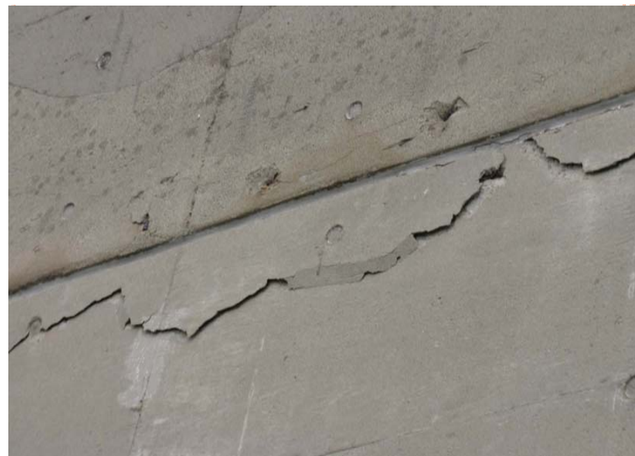
写真 鉄筋腐食に伴ってコンクリートが浮く
