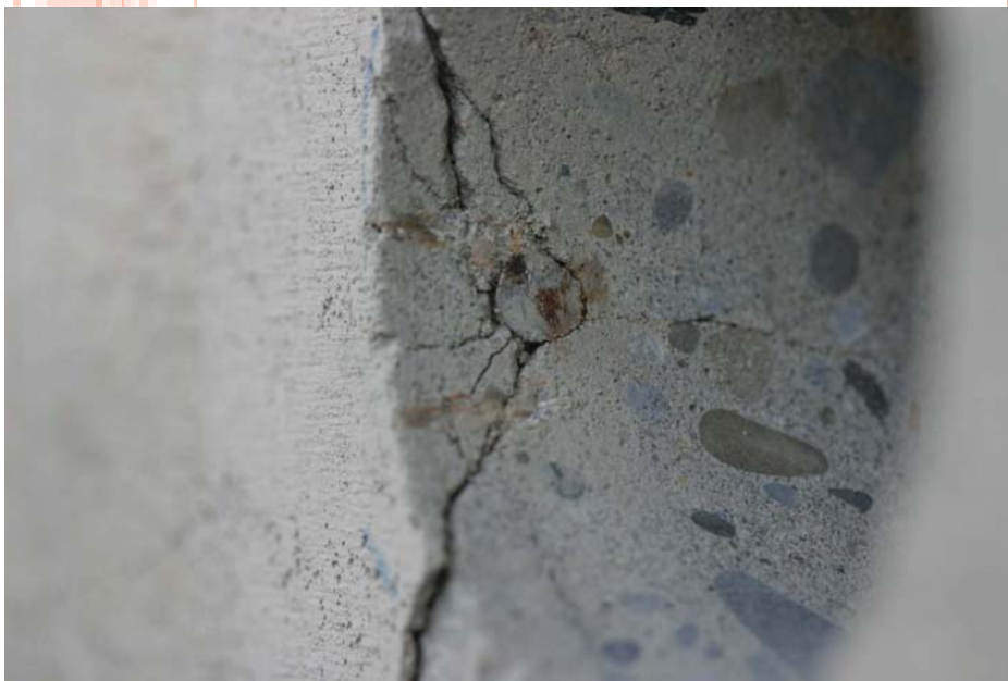
かぶりコンクリートが鉄筋の腐食時の膨張圧で押し出される
