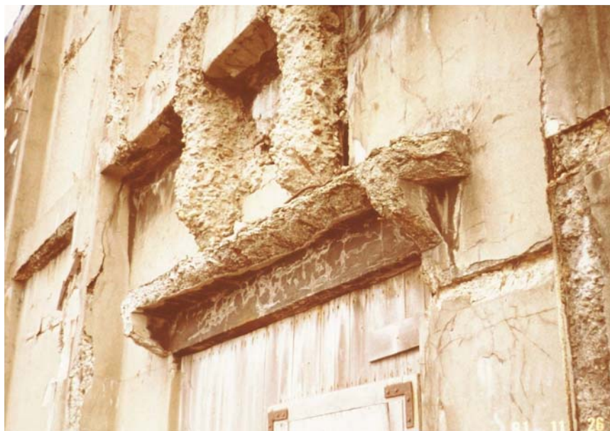
写真-11 海岸倉庫の凍害(使用禁止になって10年は経った頃の状況、塩分を含むと凍結温度が下がり厳しくなる)
