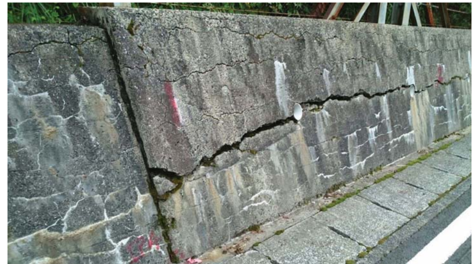
写真-19 アルカリシリカ反応による主筋方向にひび割れ
