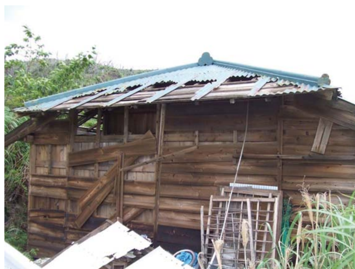
写真-2 三宅島の一戸建て住居の惨状(三宅島雄山噴火に伴う全島避難中に屋根材、内外装材の劣化が進行、木躯体崩壊寸前)
