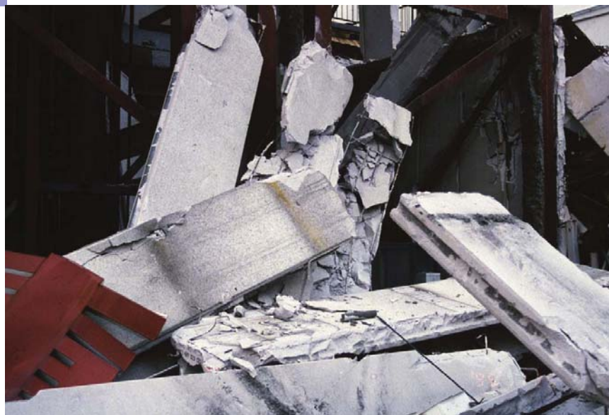
ALCパネルの落下
