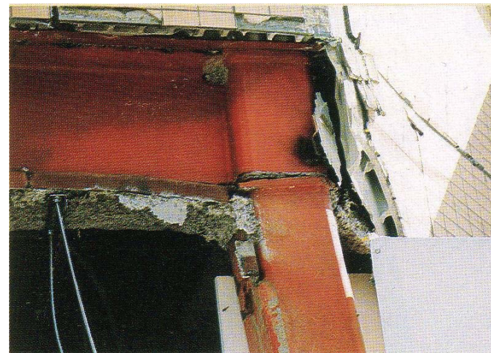
柱梁接合部の溶接破断
