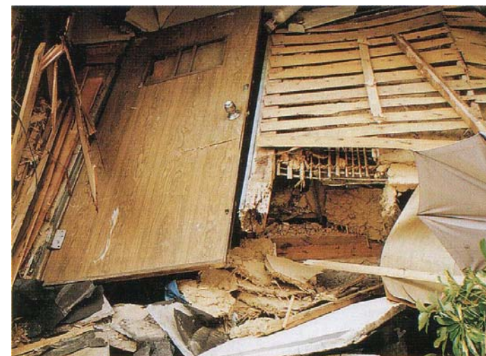
柱が腐食して根本から折れた例
