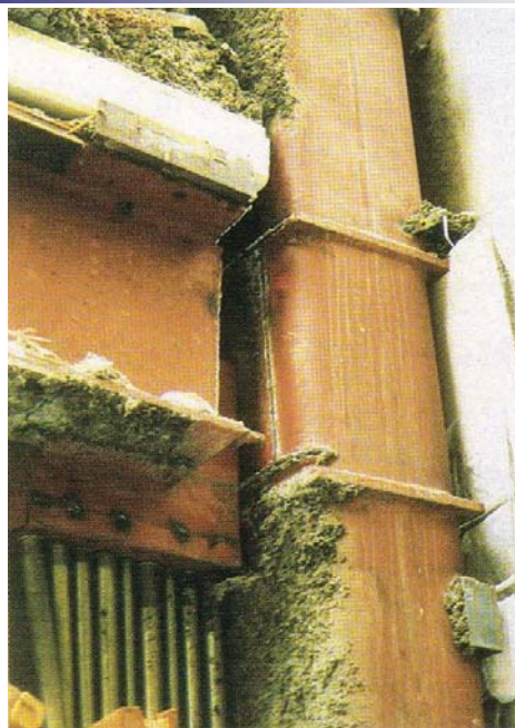
柱から梁がはずれた例
