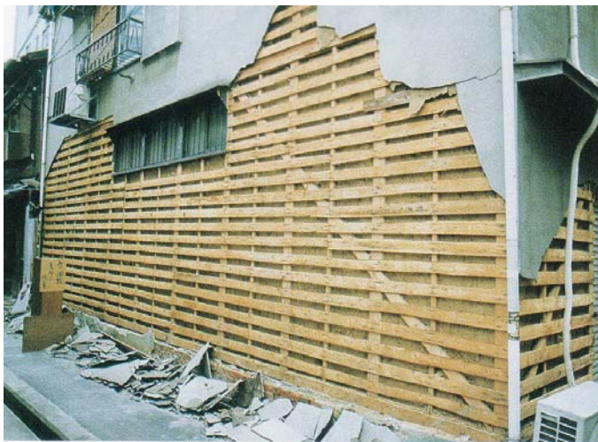
外壁は脱落したが、筋交い・下地板が有効に機能した建物
