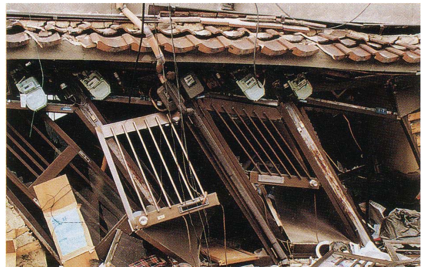
桁行方向に壁や筋交いが少なく大きな変形となった例
