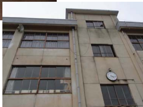
改修前 腐朽したスチールサッシ
